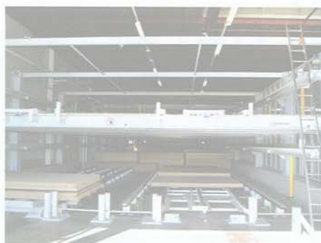
Das Zwei-Etagen-Plattenlager von BARGSTEDT ermöglicht den Zugriff auf die doppelte Menge der Lagerplätze und reduziert so die Zugriffszeit auf die verschiedenen Platten-Dekore.
